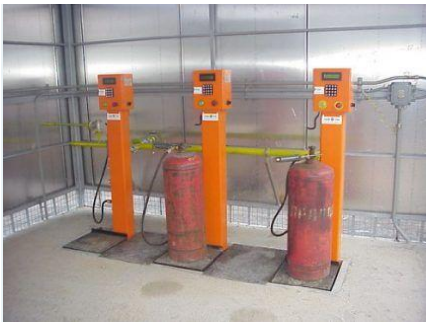
Заправка газового баллона должна контролироваться с помощью электронных весов
